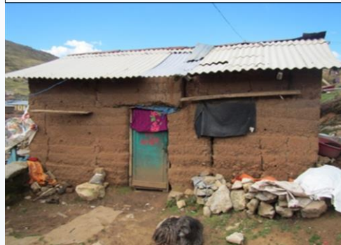
Vivienda con Daño Recuperable
