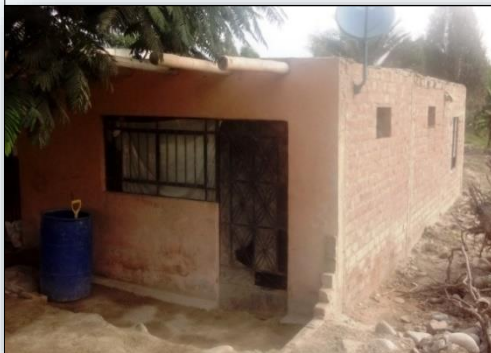
Vivienda Afectación Leve o Moderado
